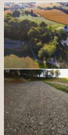
Parking moulin à vent BÉNESSE LÈS DAX (Plate-forme à ciel ouvert)
